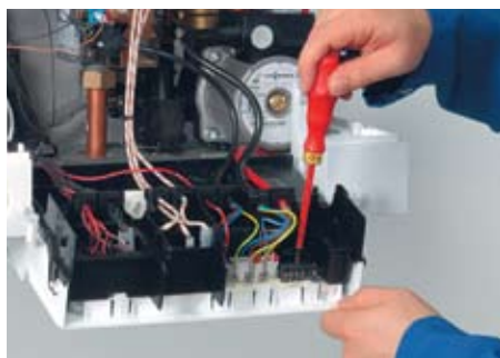
3. Подключение электрических присоединений
